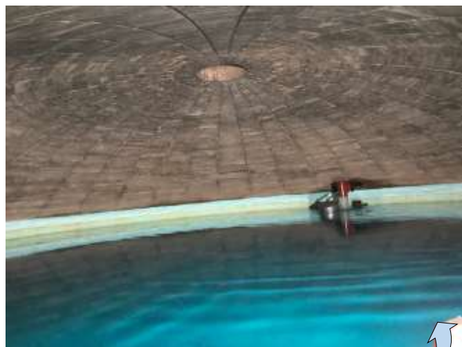
Notre réservoir principal, situé à la Verse
